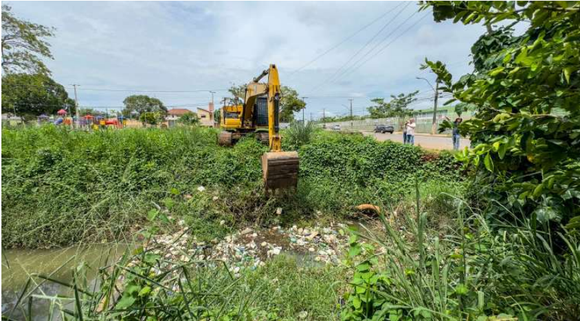
Mesmo com chuvas ainda amenas, resíduos acumulados em bueiros e canais podem provocar alagamentos.
