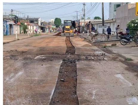
Empresa foi responsabilizada por não recompor trecho da Rua Benedito de Souza Brito após abertura de valas para instalação de tubulação.
