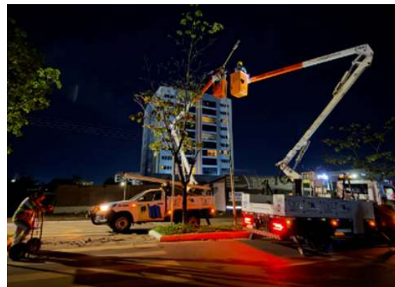
O atendimento facilita o registro de pedidos e ocorrências na iluminação pública.
