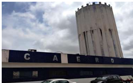
Tribunal aponta possível falta de planejamento técnico e dá prazo para presidente da Emdur apresentar esclarecimentos sobre a execução da obra.
