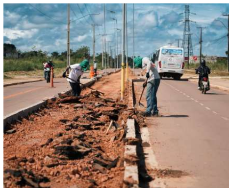
Tribunal aponta possível falta de planejamento técnico e dá prazo para presidente da Emdur apresentar esclarecimentos sobre a execução da obra.
