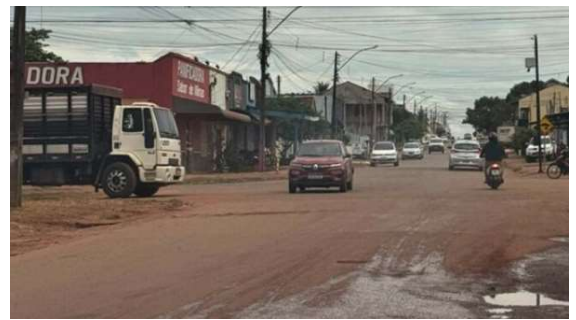
O escoamento contínuo de água sobre o asfalto pode deixar a pista escorregadia, aumentando o perigo, principalmente em locais de grande circulação.
