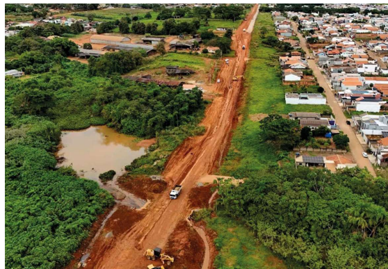
Orçada em R$ 15 milhões, a pavimentação da Linha 625 é uma obra de grande porte.
