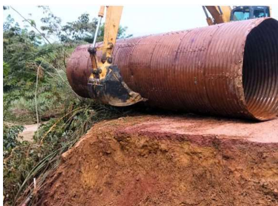
Após a situação ser detectada, a 2ª Residência Regional em Ariquemes mobilizou equipes e deu início ao planejamento das ações.
