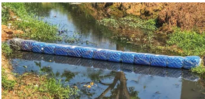
Estruturas instaladas já retêm cerca de 30 quilos de lixo por dia e serão ampliadas para outros pontos estratégicos da cidade.
