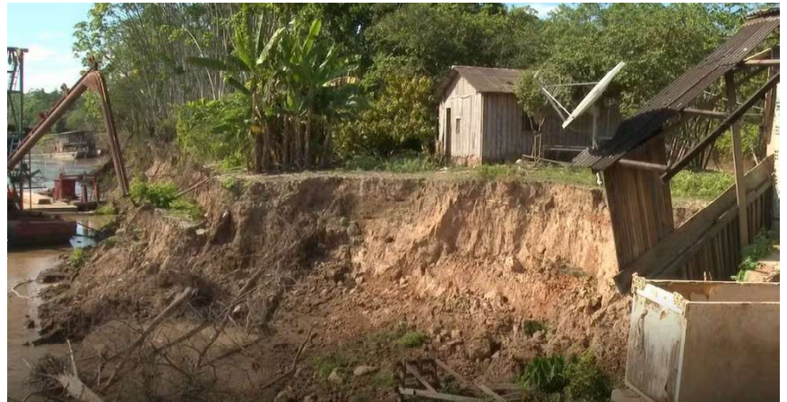
Erosão começou após a cheia de 2025. Defesa Civil instalou placas para alertar sobre o risco na estrada que dá acesso a Porto Velho.
