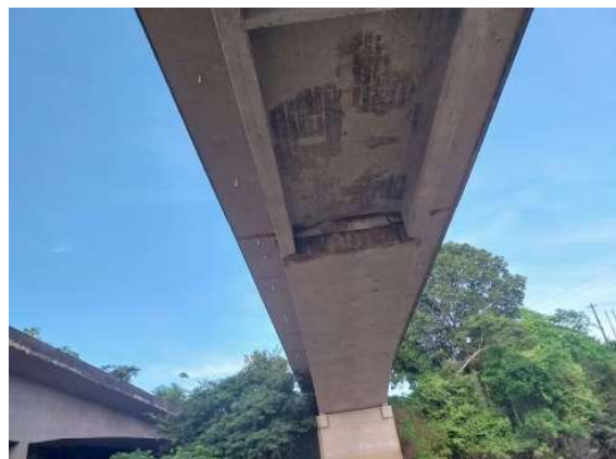
Ponte apresentou rachaduras
