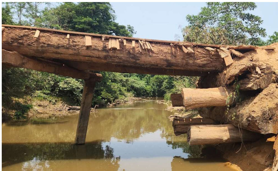
Ponte está em estado precário
